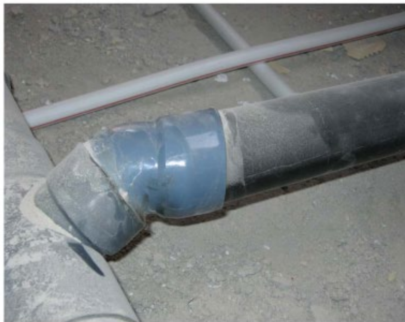
شکل ۱۲- گرم کردن نامناسب اتصالات
