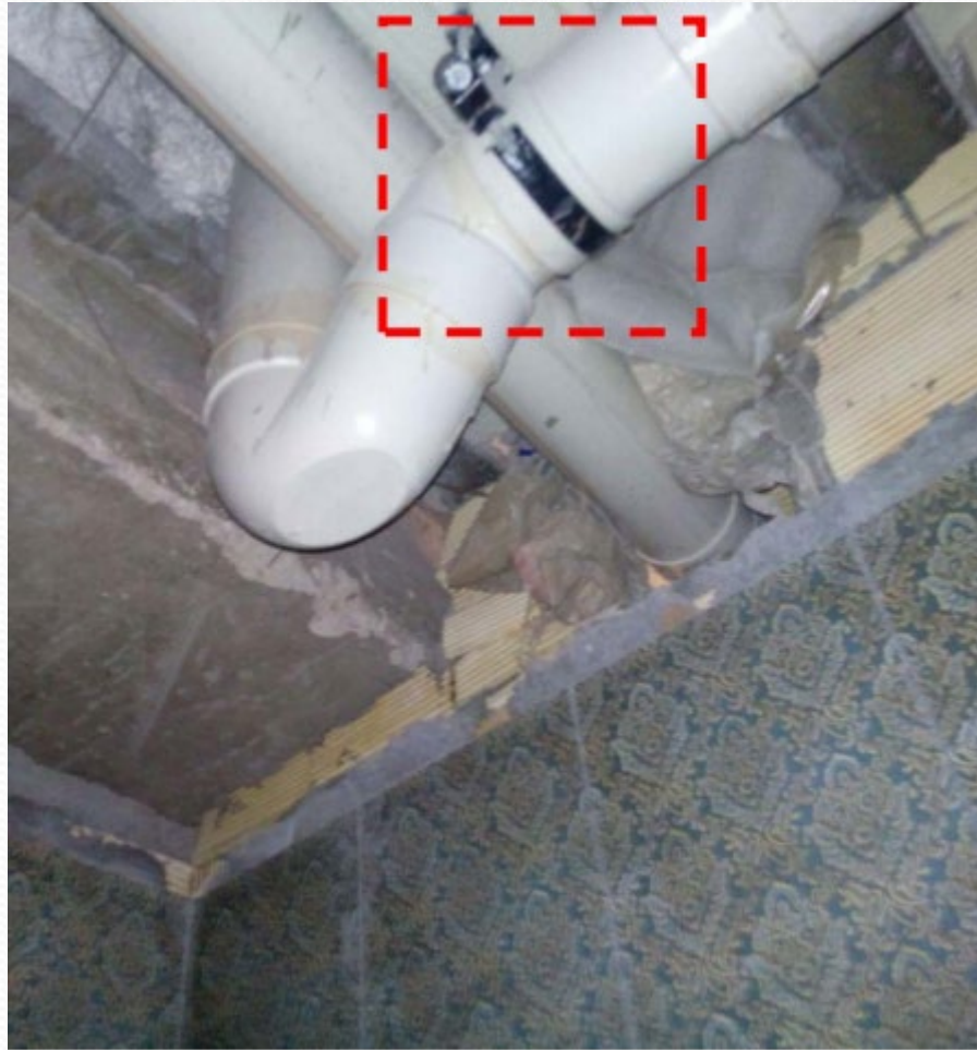
شکل ۳۵- مهاربندی نامناسب سیفون
