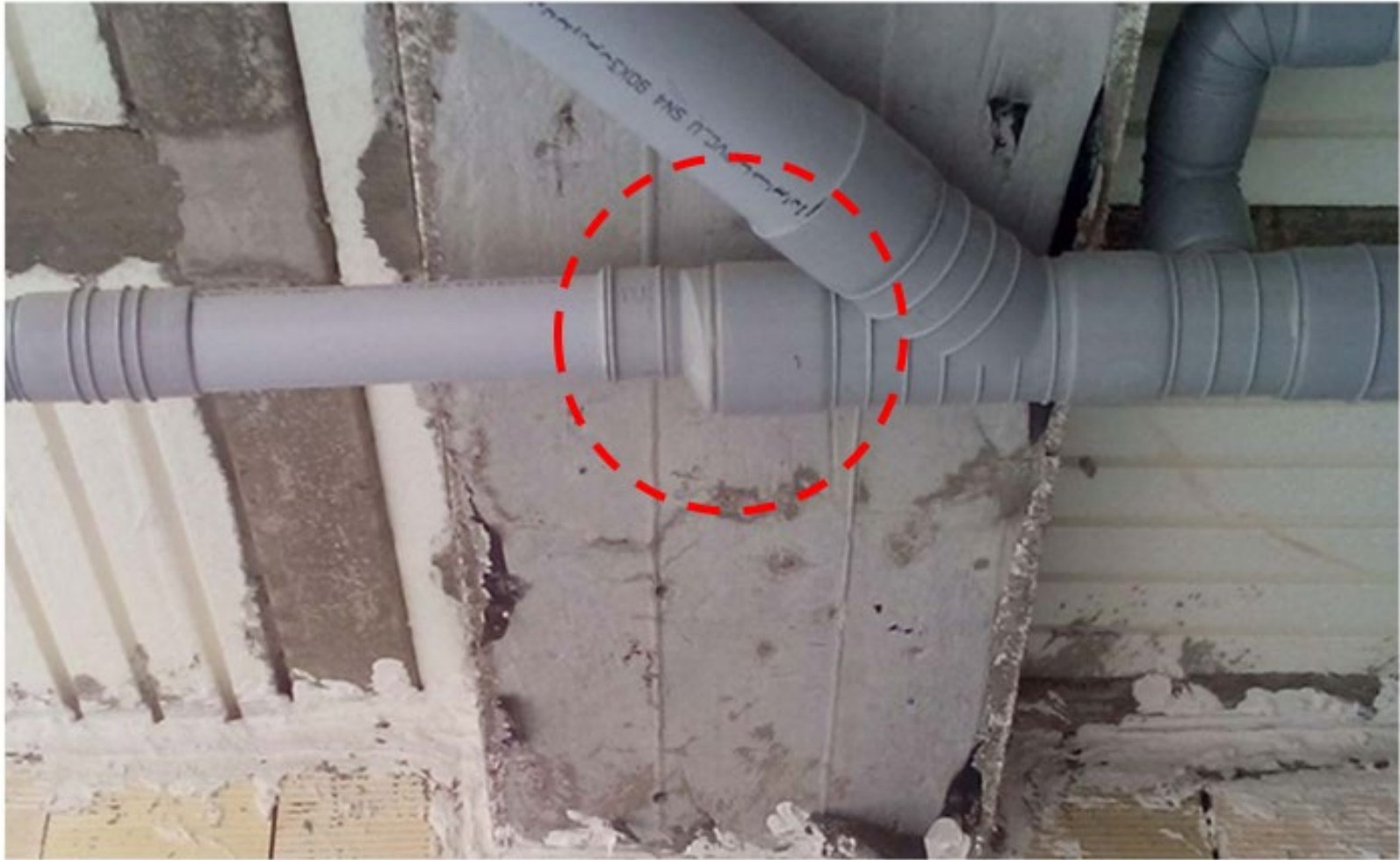
شکل ۲۷- اجرای نادرست تبدیل
