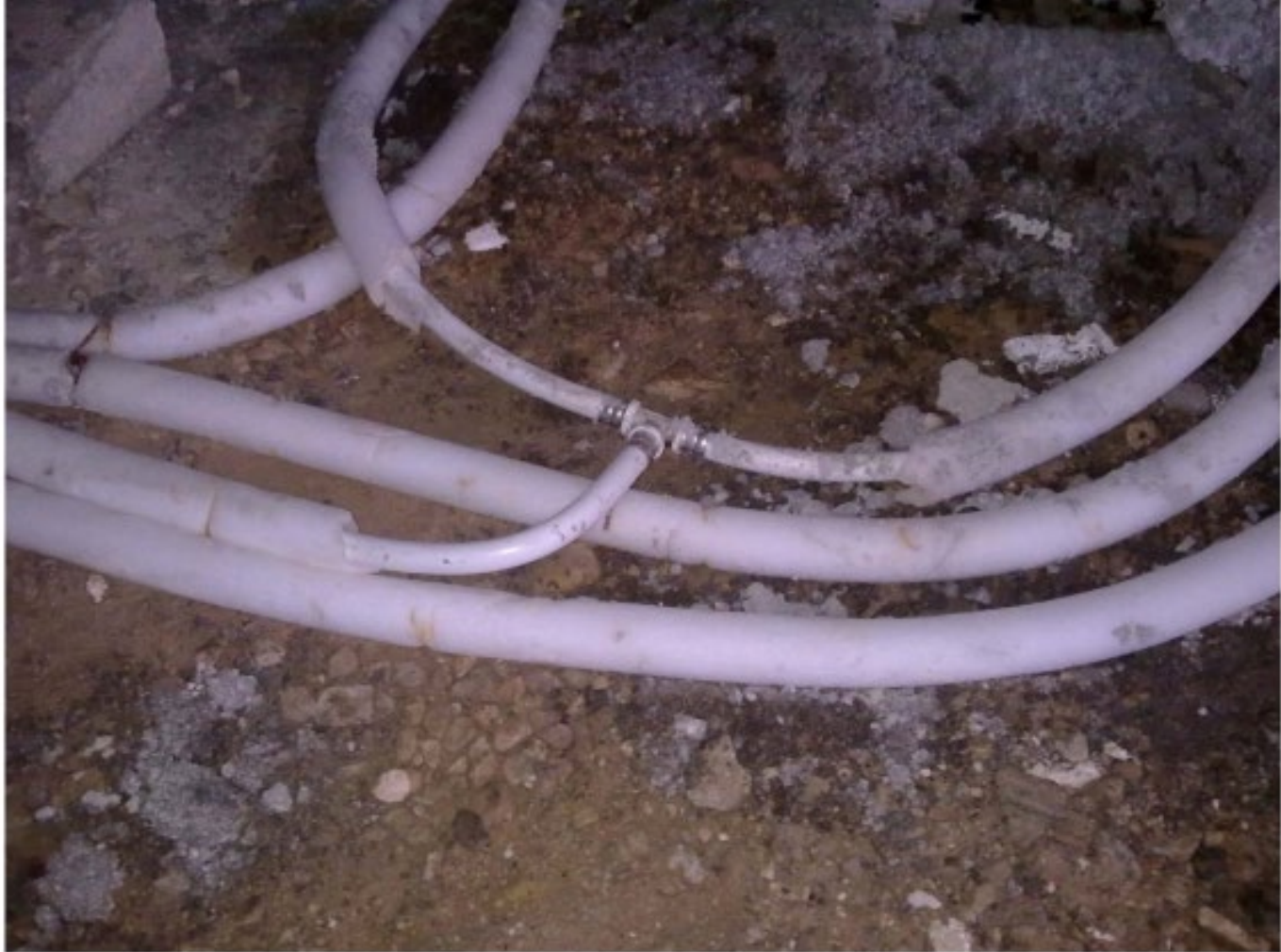
شکل ۳- عدم عایق رطوبتی اتصالات
