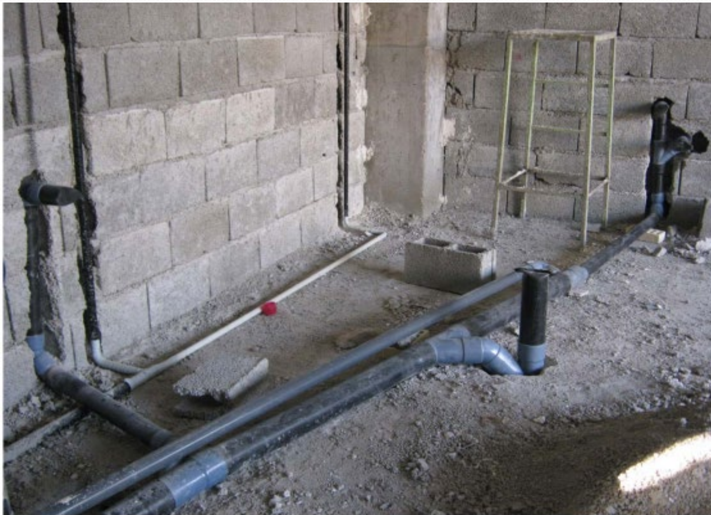
شکل ۱۱- عدم اجرای سیفون و غیرهمجنس بودن لوله و اتصالات
