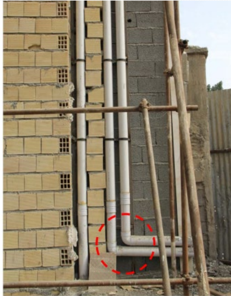
شکل ۲۶- اجرای نادرست رایزر آب باران
