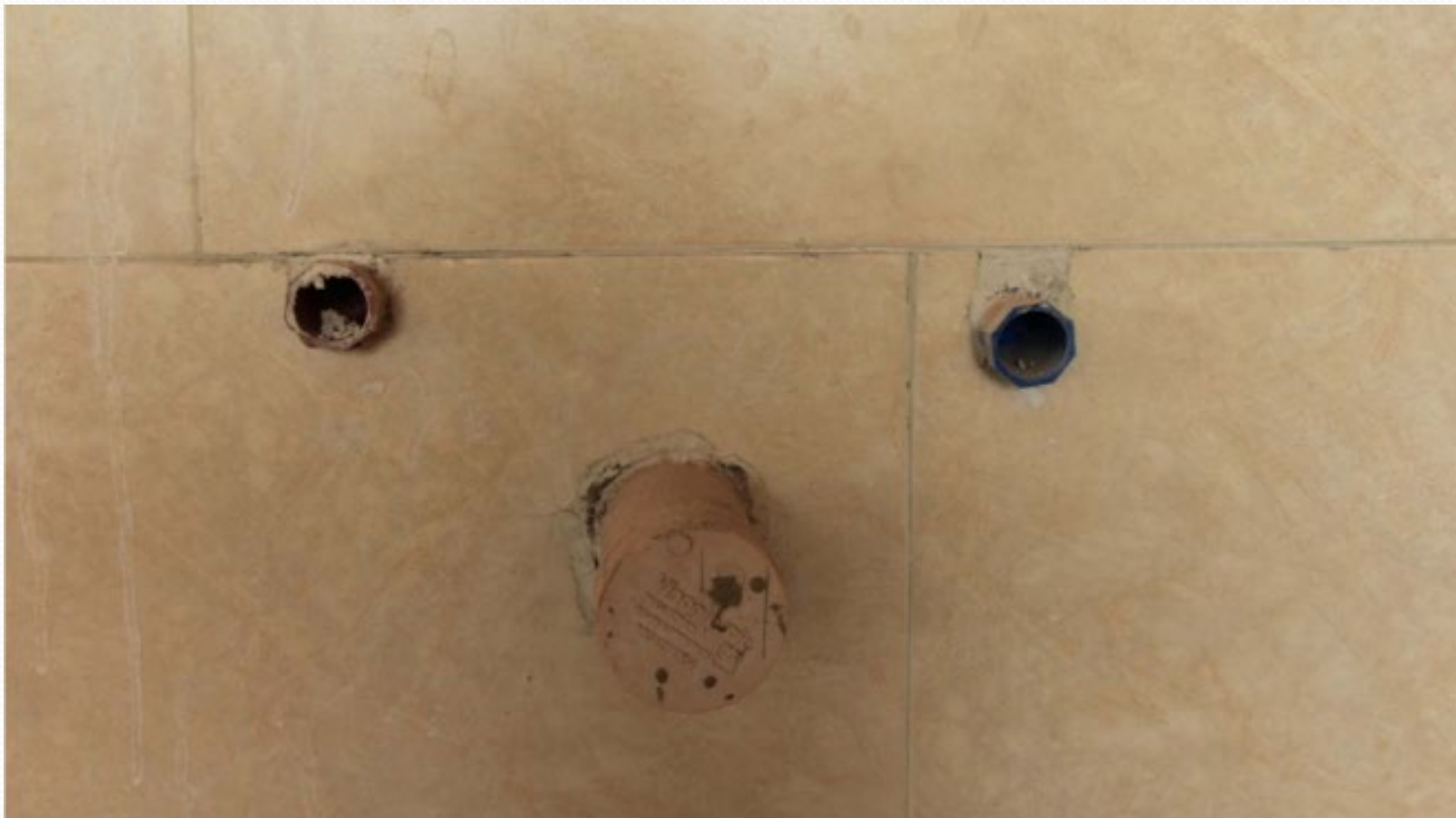
شکل ۳۰- عدم استفاده از شابلون در اجرای انشعاب آب مصرفی
