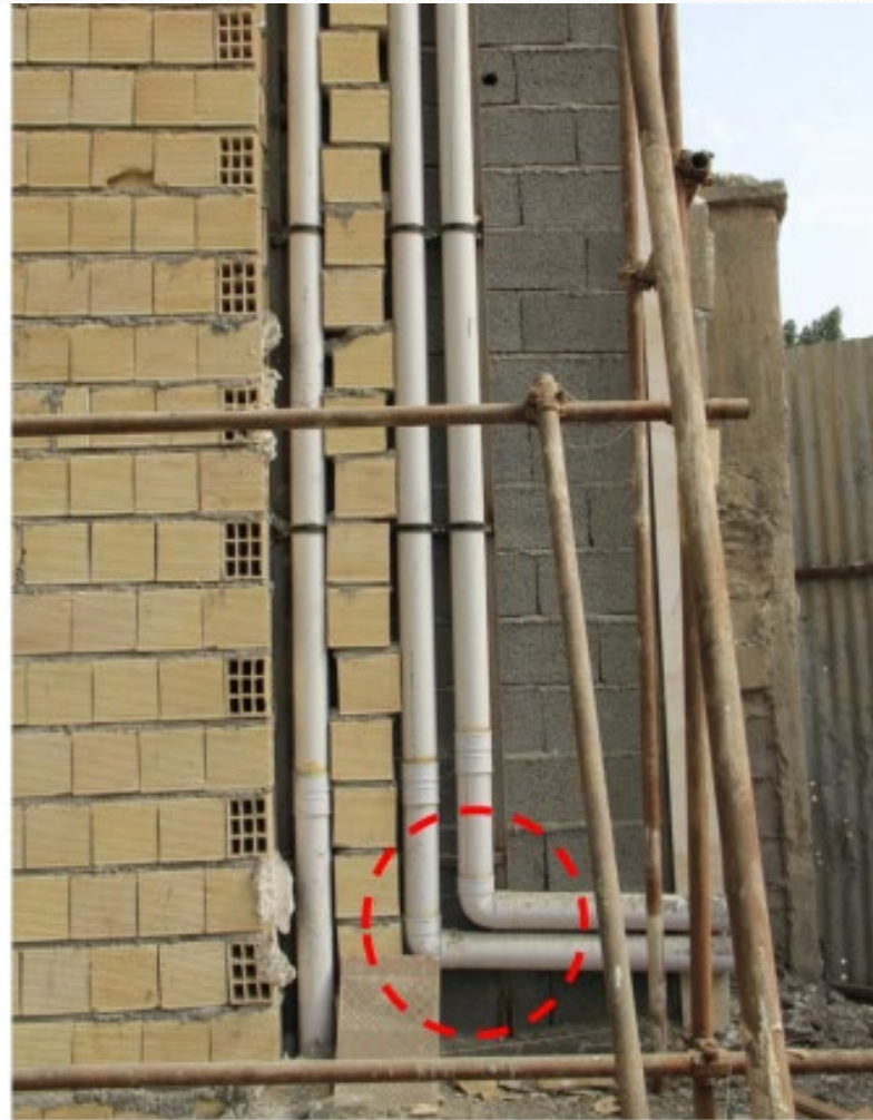
شکل ۲۶- اجرای نادرست رایزر آب باران
