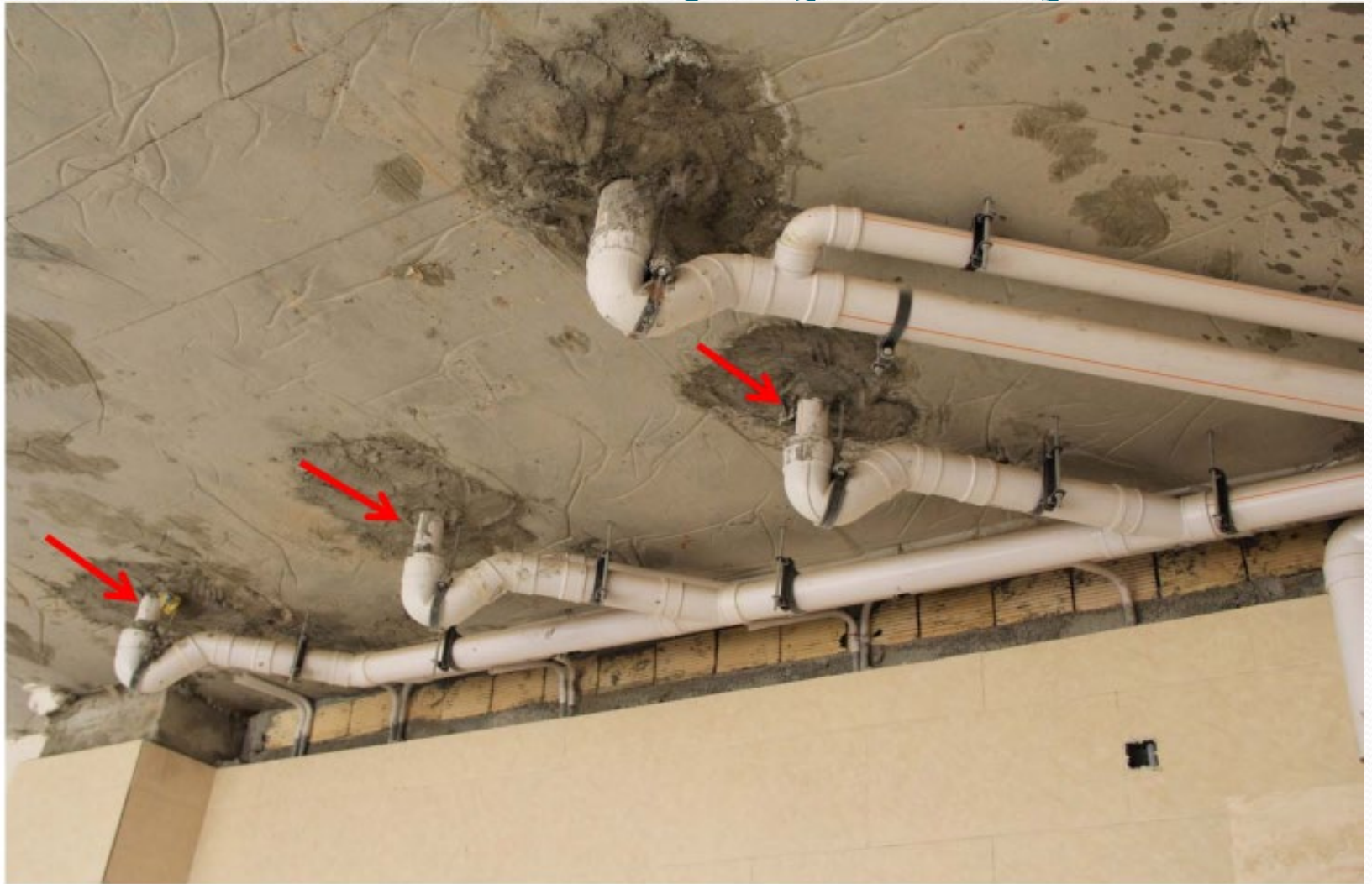
شکل ۲۸- اجرای نادرست از تبدیل ۲ به ۳ و عدم نصب دریچه بازدید در محل افقی خط
