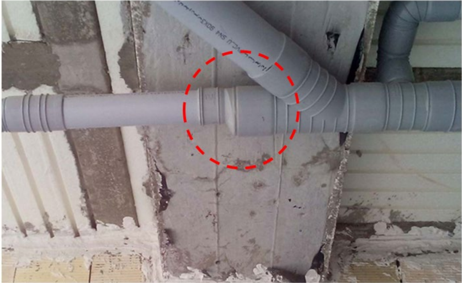
شکل ۲۷- اجرای نادرست تبدیل
