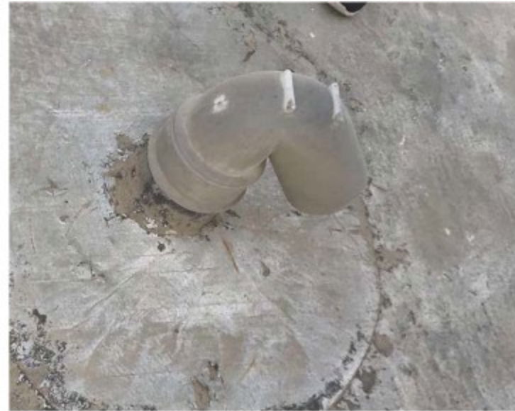
شکل ۳۶- اجرای نامناسب خط هواکش و استفاده از کلاهک نامناسب بر روی رایزر هواکش در پشت بام
