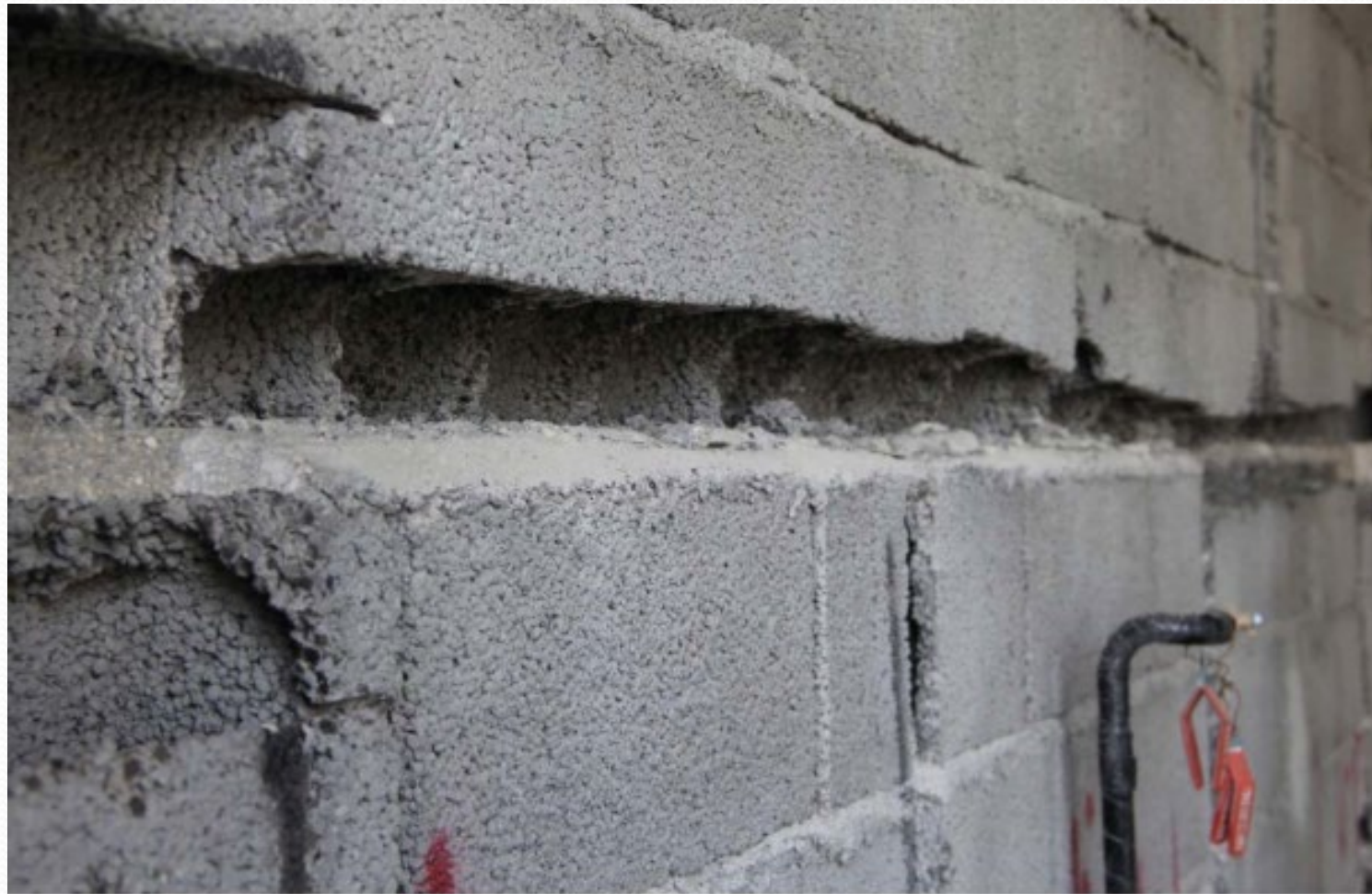
شکل ۳۳- تخریب بیش از حد دیوار داخلی جهت اجرای تاسیسات
