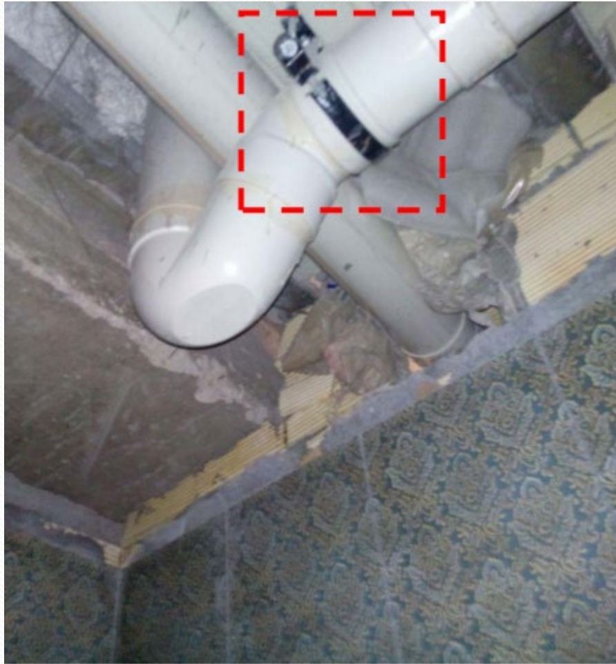
شکل ۳۵- مهاربندی نامناسب سیفون
