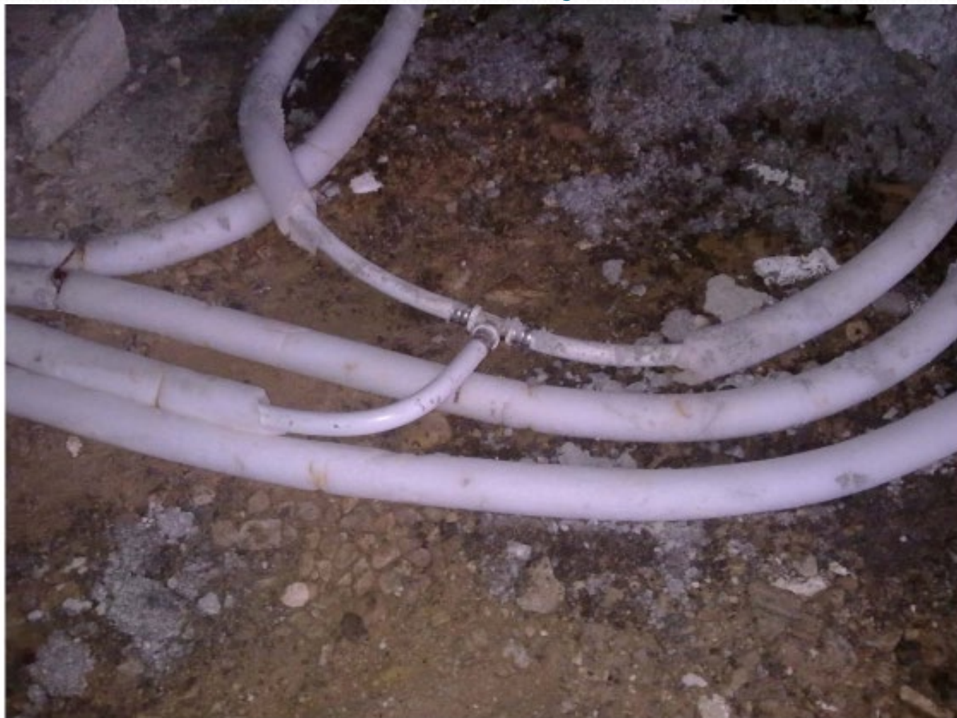
شکل ۳- عدم عایق رطوبتی اتصالات
